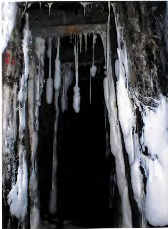
Pilzbefall der Türstöcke
