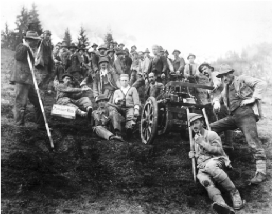
Kompressor-Transport zur Baustelle der Eckersbach-Wehr, die auf dem Weg zur Passauerhütte liegt
